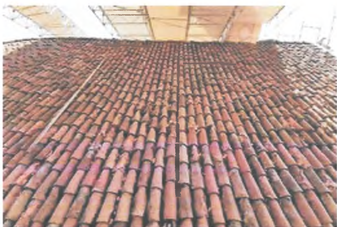
Copertura dei coppi ammalorati
