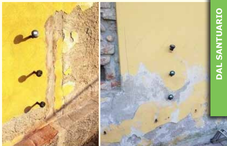
Fase di misurazione di una prova igrometrica per verificare il contenuto d'acqua nelle murature perimetrali
